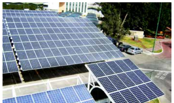
Estacionamiento solar | Potencia de 162.15 kWp
