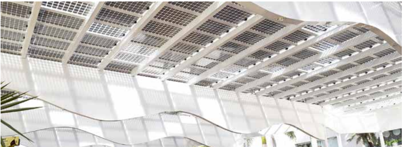
Paneles semitransparentes, León, Gto. | Potencia de 245.5 kWp
