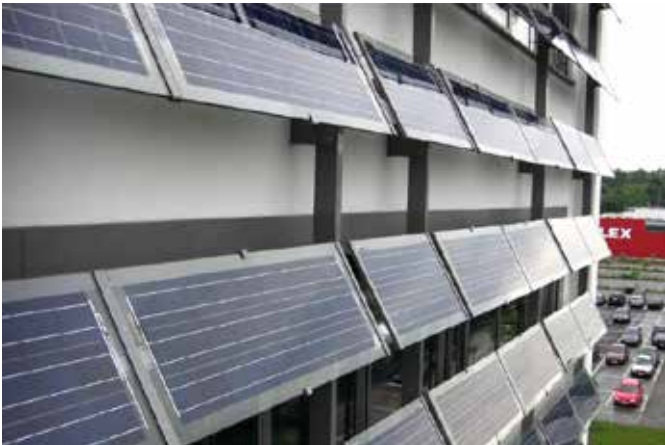
SMA Niestetal, Alemania | Potencia de 23.80 kWp
